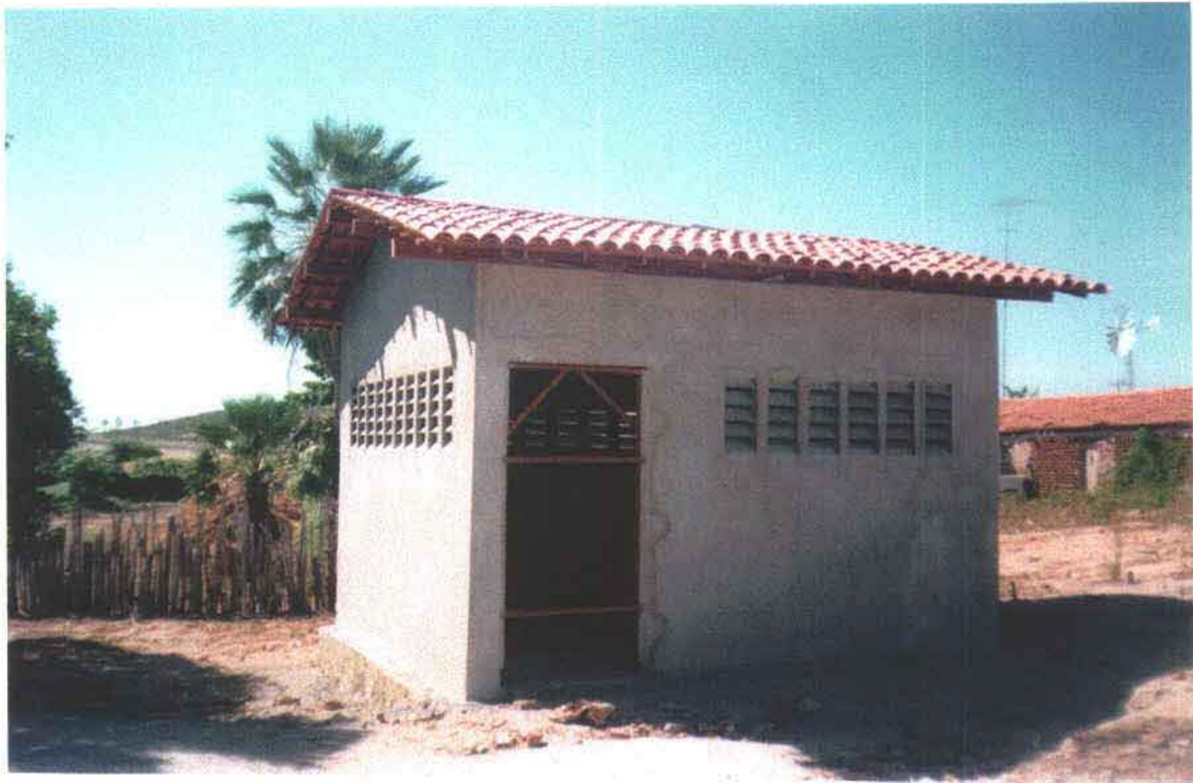
Foto 34 – Casa de bombas da estação elevatória EE-4.
