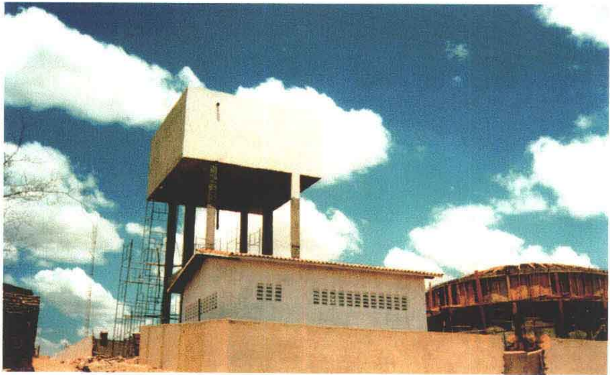
Foto 29 – Reservatório elevado de 200 m 3 ; Reservatório apoiado de 200 m 3 e casa de bombas.
