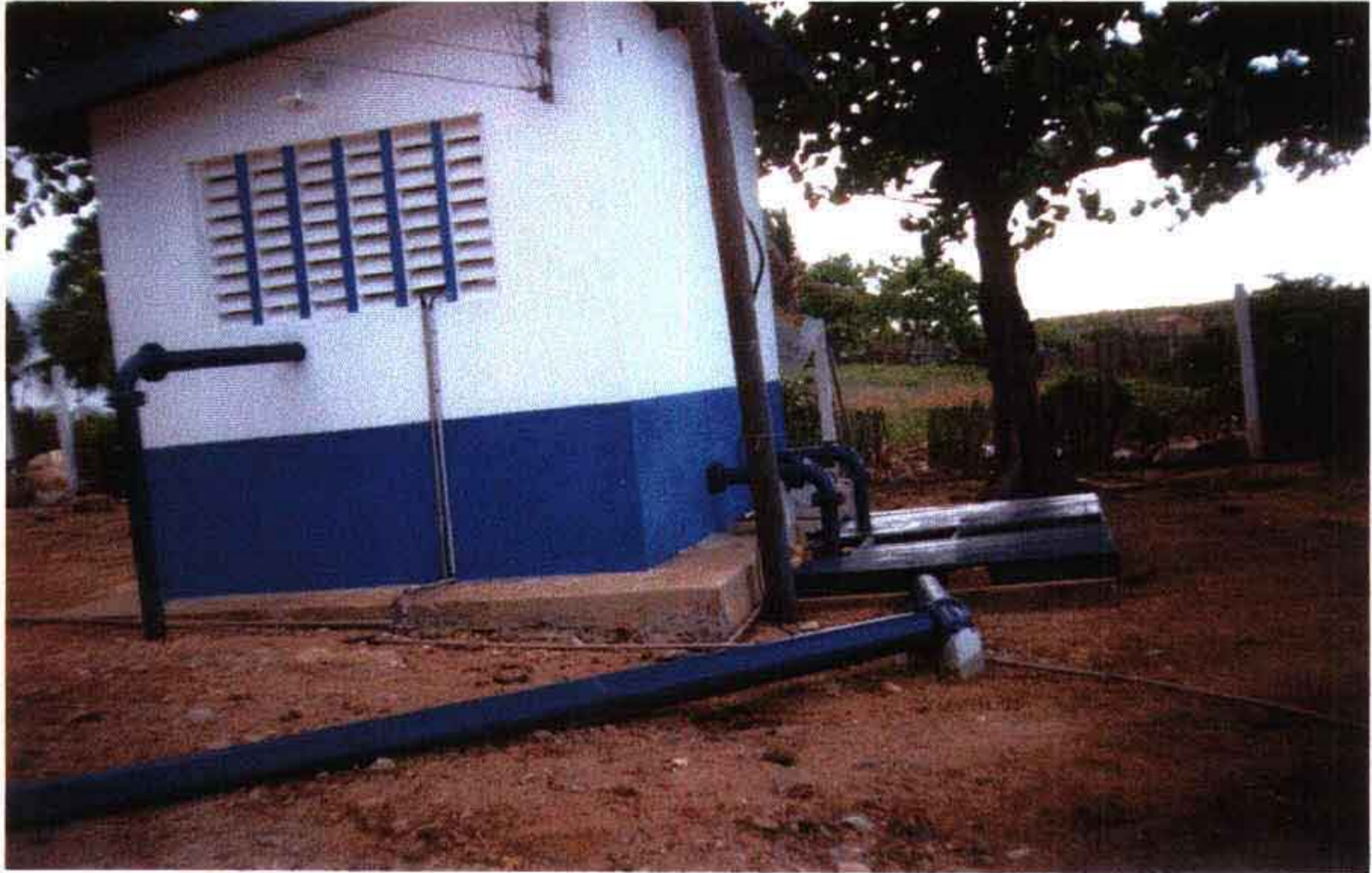
Foto 30 – Estação elevatória e reservatório enterrado. Capacidade 25 m 3 .
