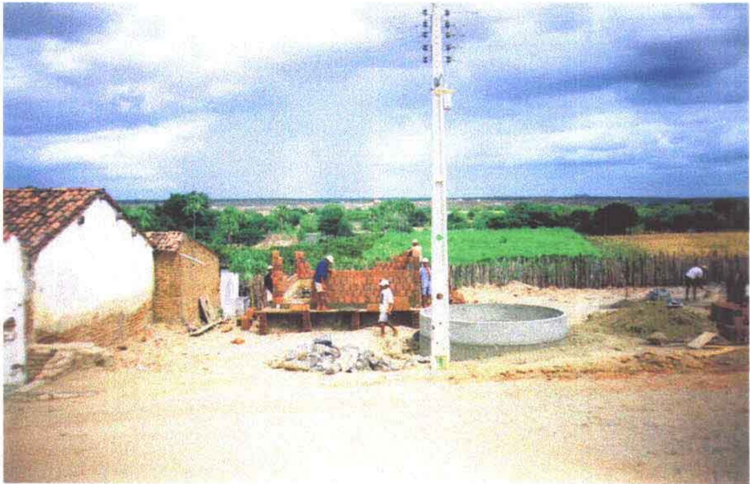
Foto 22 – Início da execução da casa de bomba da estação elevatória EE-1 e do reservatório elevado de 80 m 3 . Na ETA.
