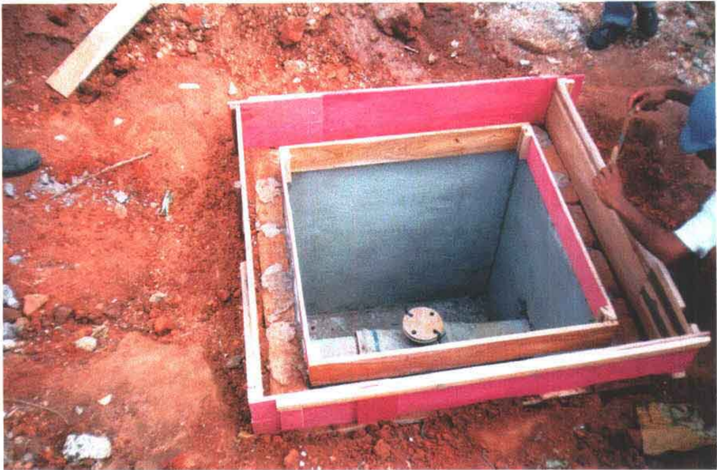
Foto 03 – Execução da caixa para ventosa em alvenaria de tijolo maciço, conforme padrão CAGECE.
