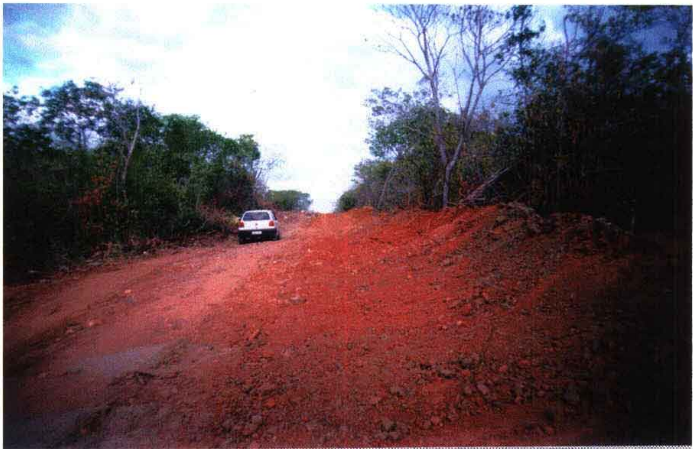
Foto 06 – Valas aterradas e caminho de serviço em um dos trechos da adutora.
