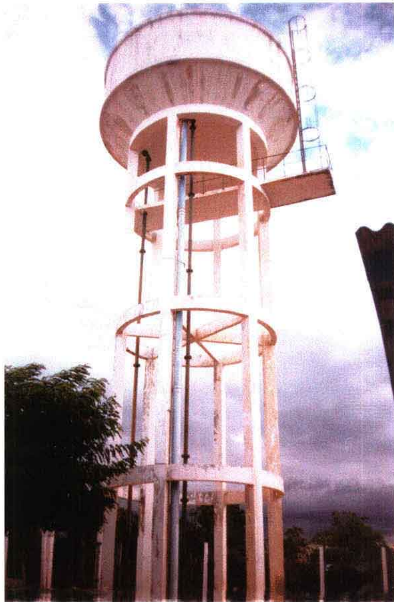
Foto 30 – Reservatório elevado. Capacidade 100 m 3 .
