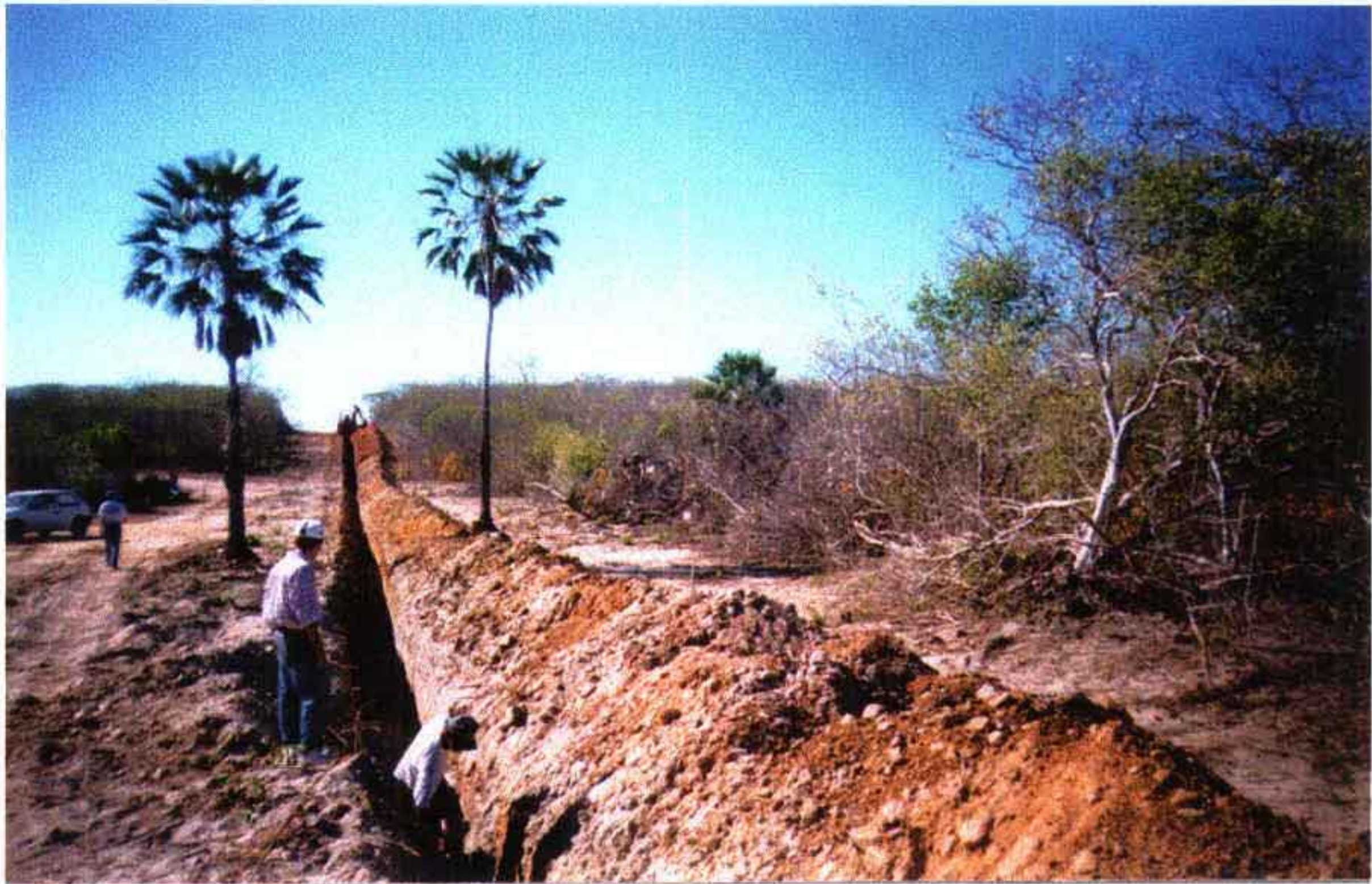
Foto 07 – Valas escavadas com profundidades inferiores as de projeto, sendo refeitas nas estacas 879 e 735 respectivamente.
