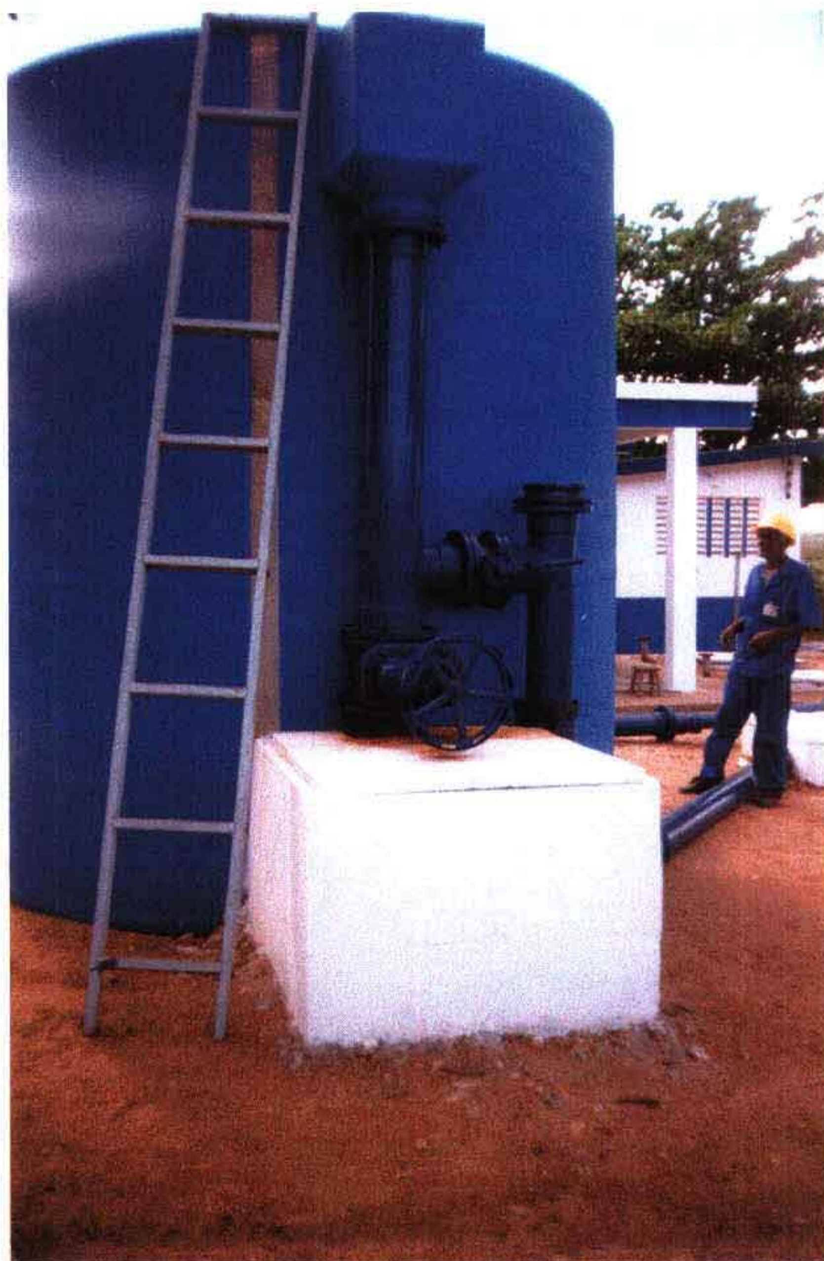
Foto 31 – Filtro de fluxo ascendente. Capacidade 53 m 3 /h, tipo Henfíbra.
