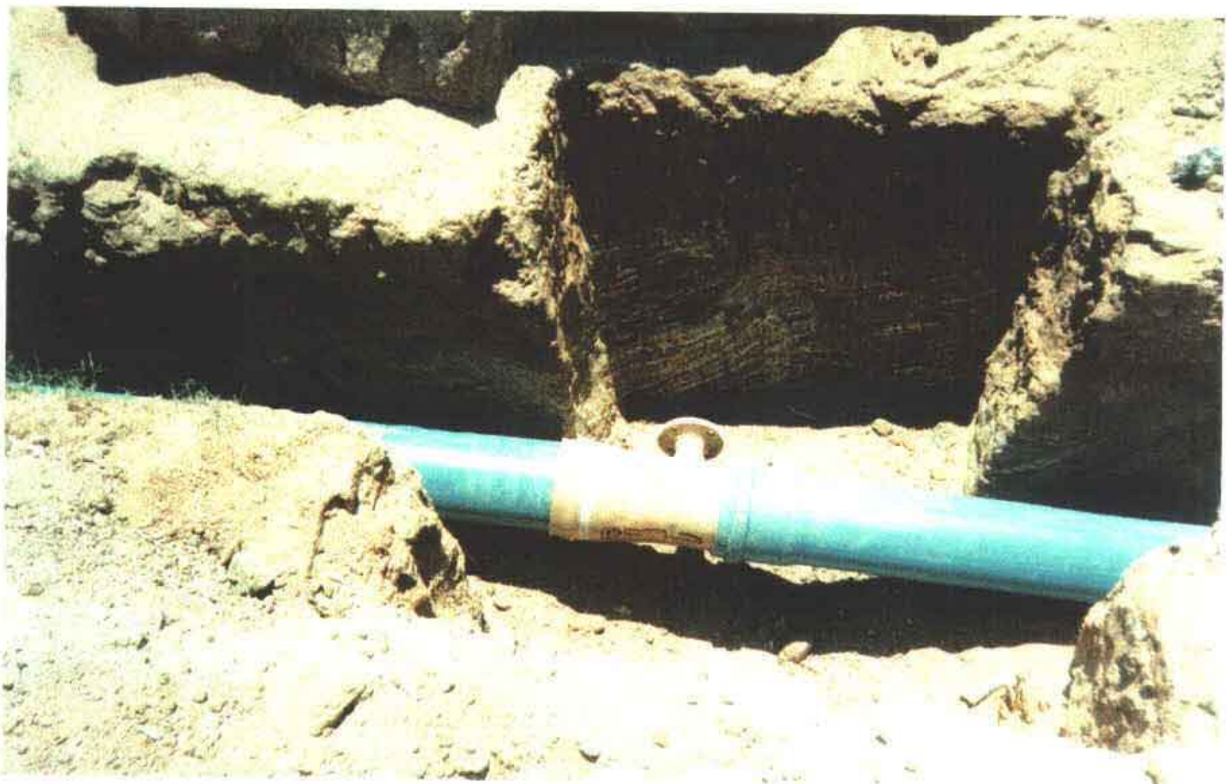
Foto 19 – Detalhe do início da escavação em rocha para caixa de registro de descarga.
