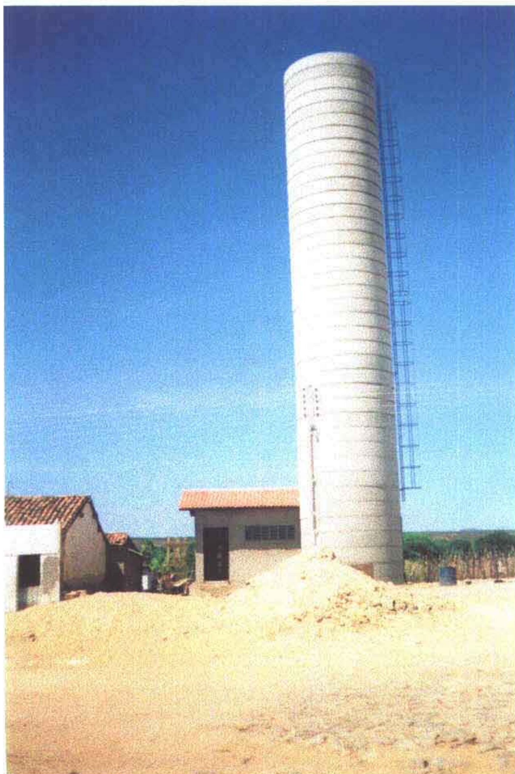
Foto 23 – Casa de bombas da estação elevatória EE-1 e reservatório elevado de 80 m 3 . Na ETA.
