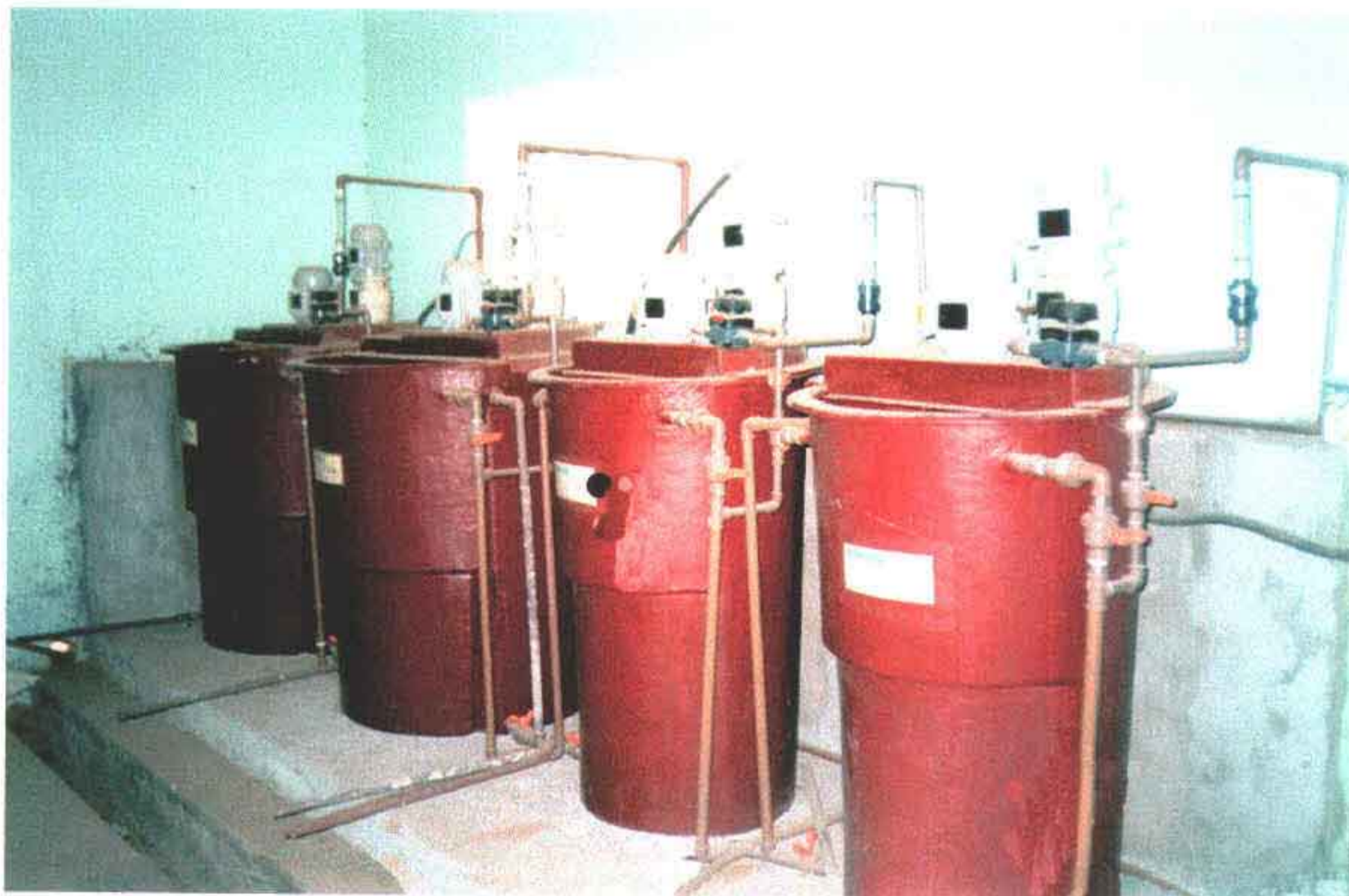
Foto 33 – Tanques desadores para sulfato de alumínio e cloro na casa de Química sendo instalados pela construtora responsável pelas obras da rede de distribuição.
