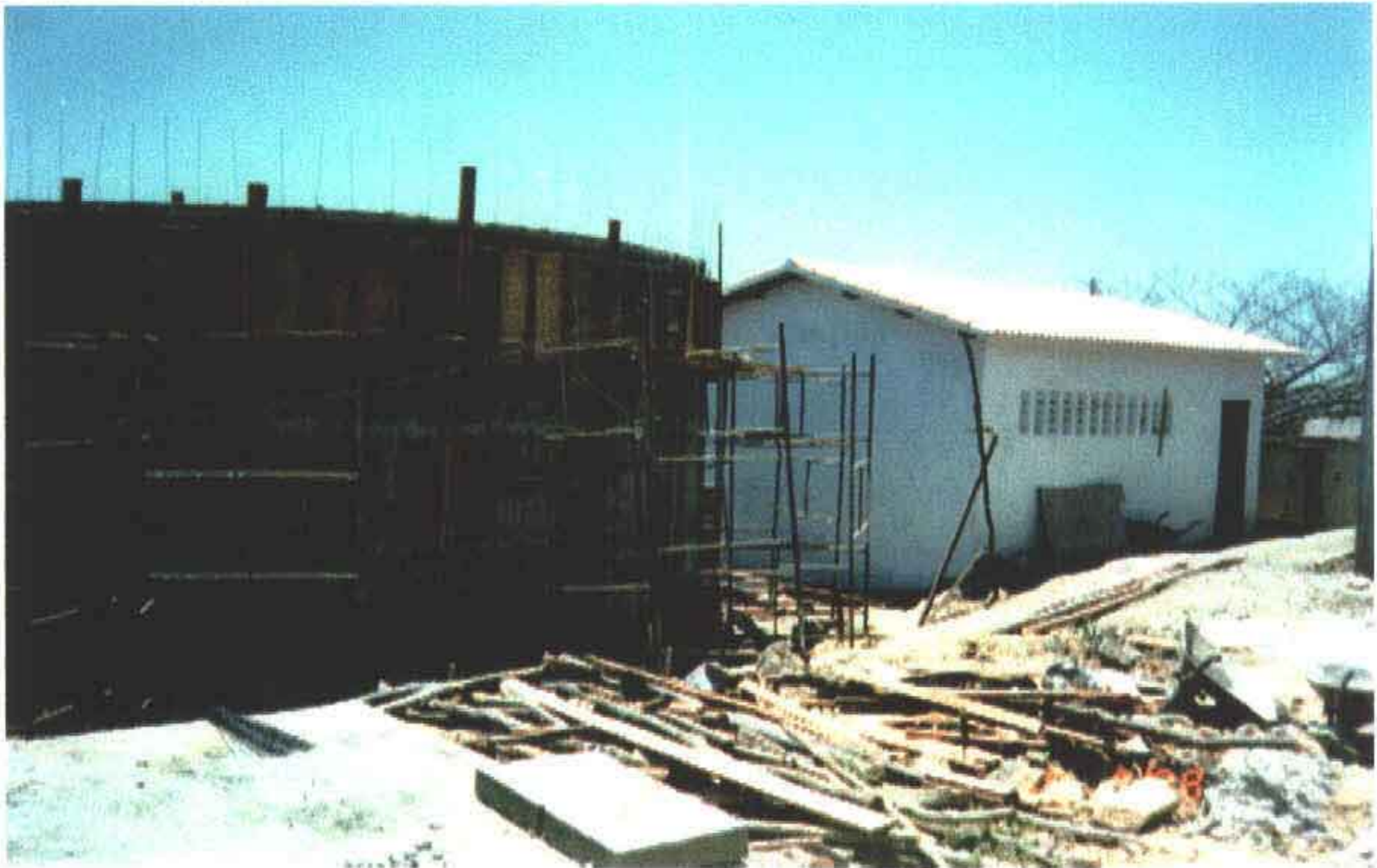
Foto 23 – Reservatório apoiado de 200 m 3 e casa de bombas.
