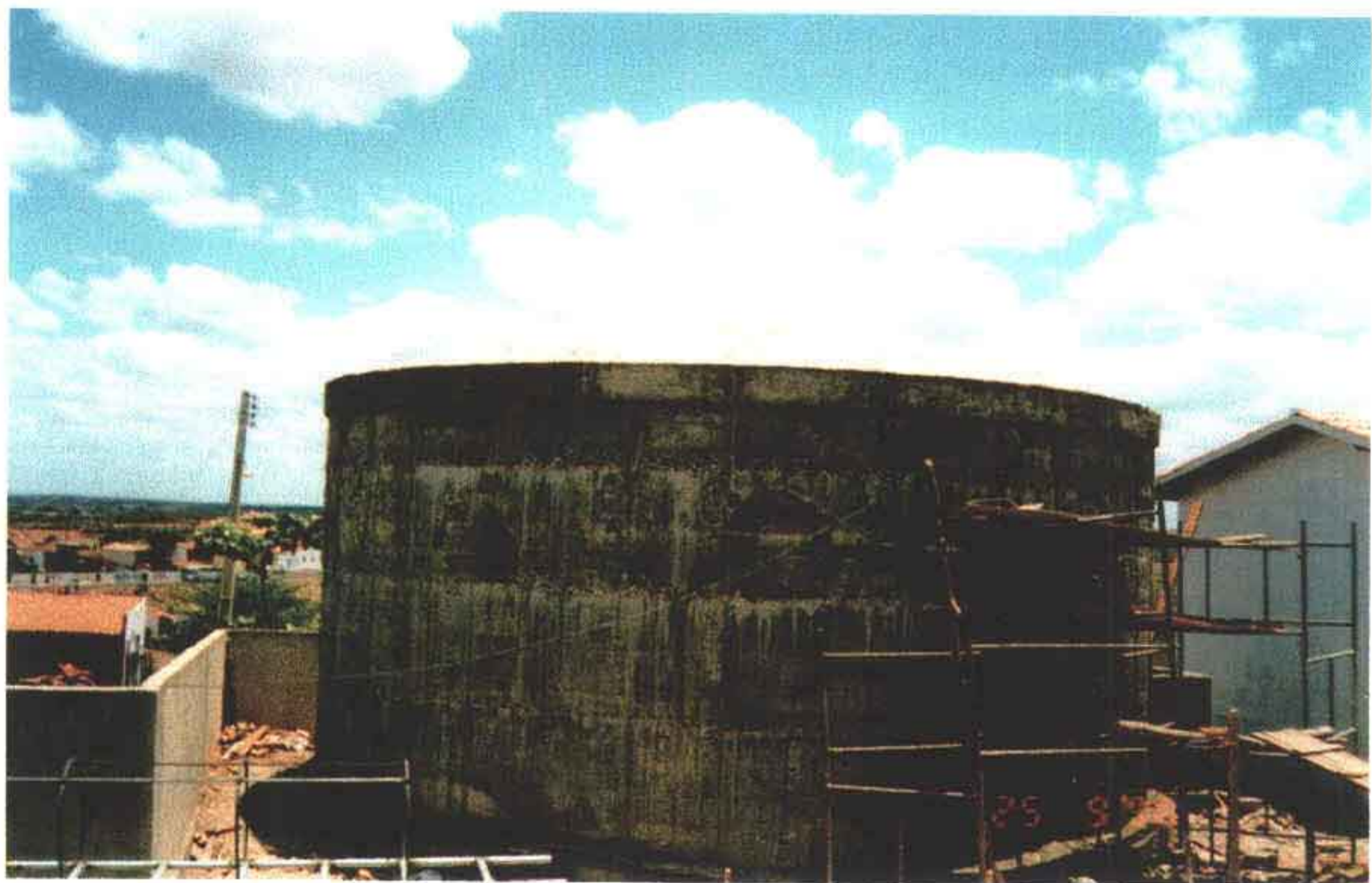
Foto 26 – Reservatório apoiado 200 m 3 .
