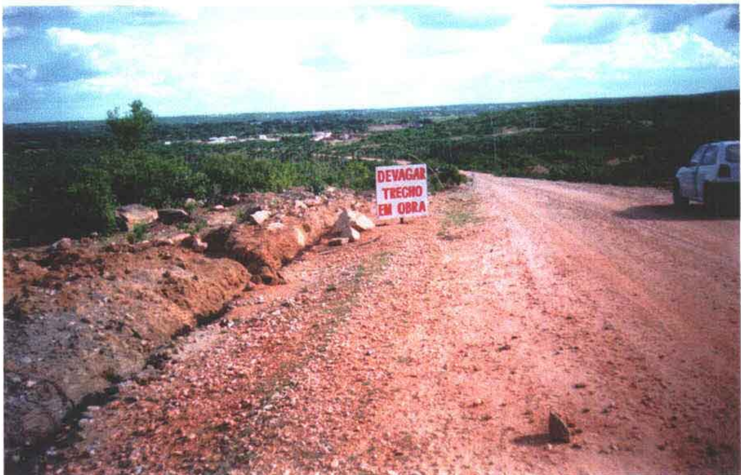
Foto 02 – Sinalização de advertência.
