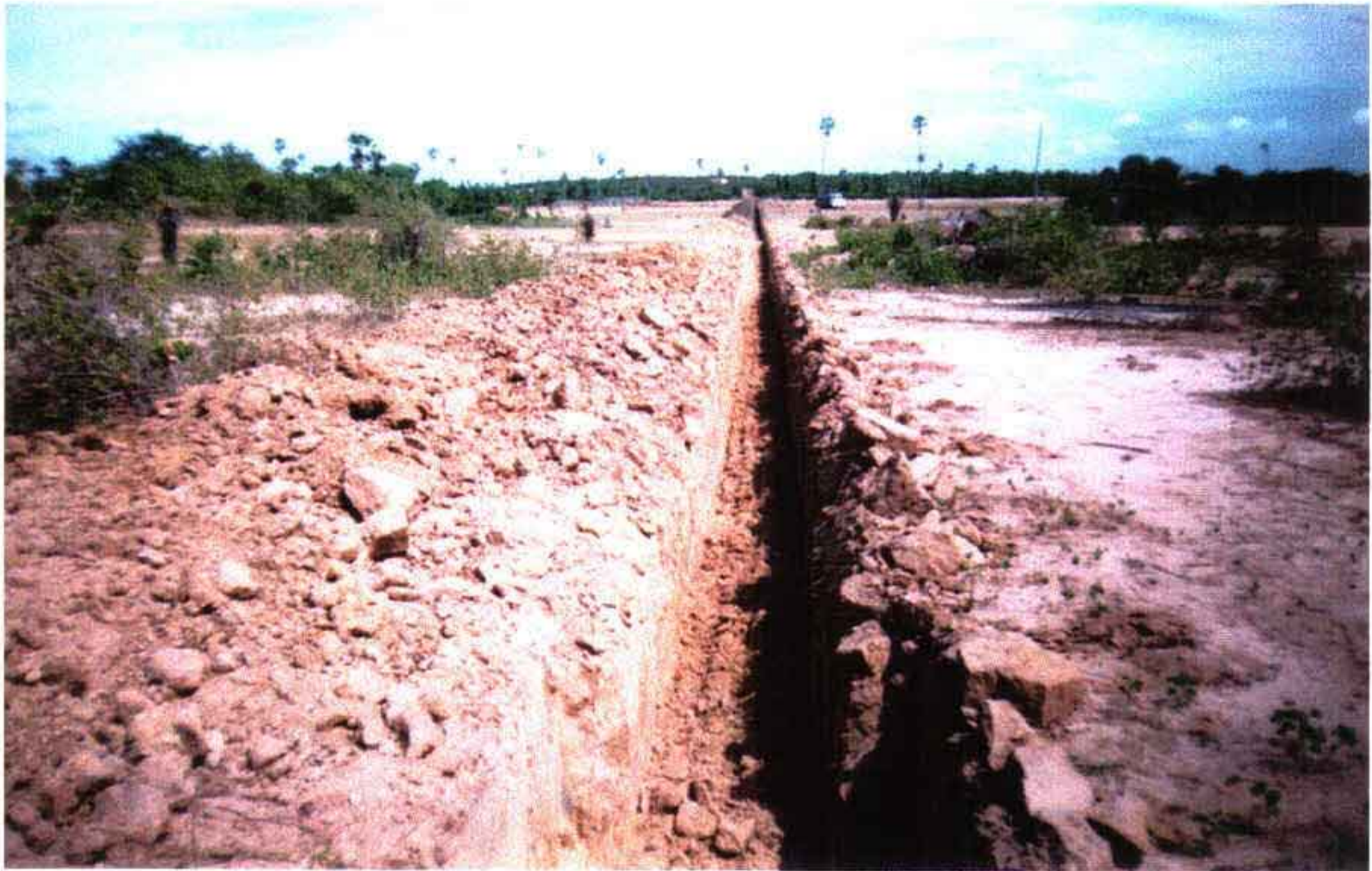
Foto 03 – Vala escavada faltando a regularização do fundo.
