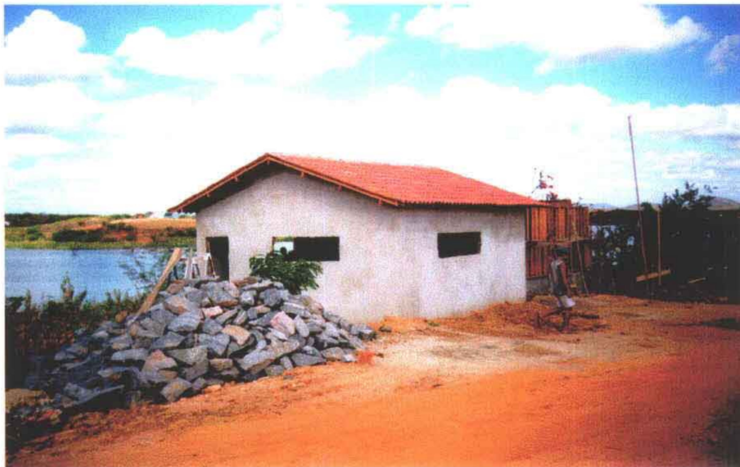
Foto 11 – Estação elevatória EE-2 – Casa de Bombas e reservatório de 50 m 3 em construção.
