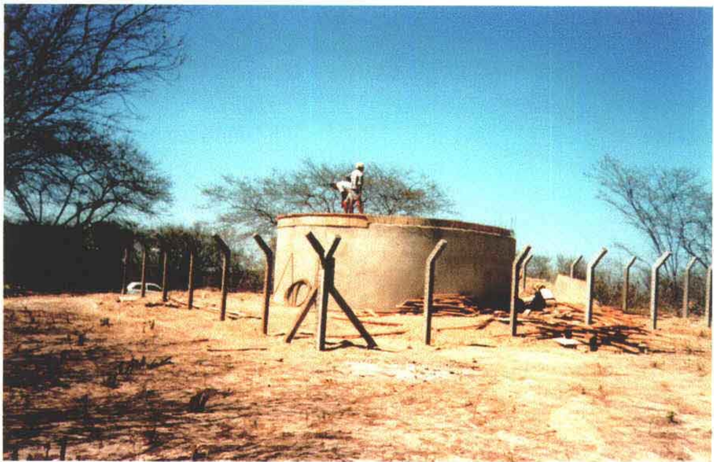
Foto 18 – Reservatório apoiado de 100 m 3 e cerca de proteção.
