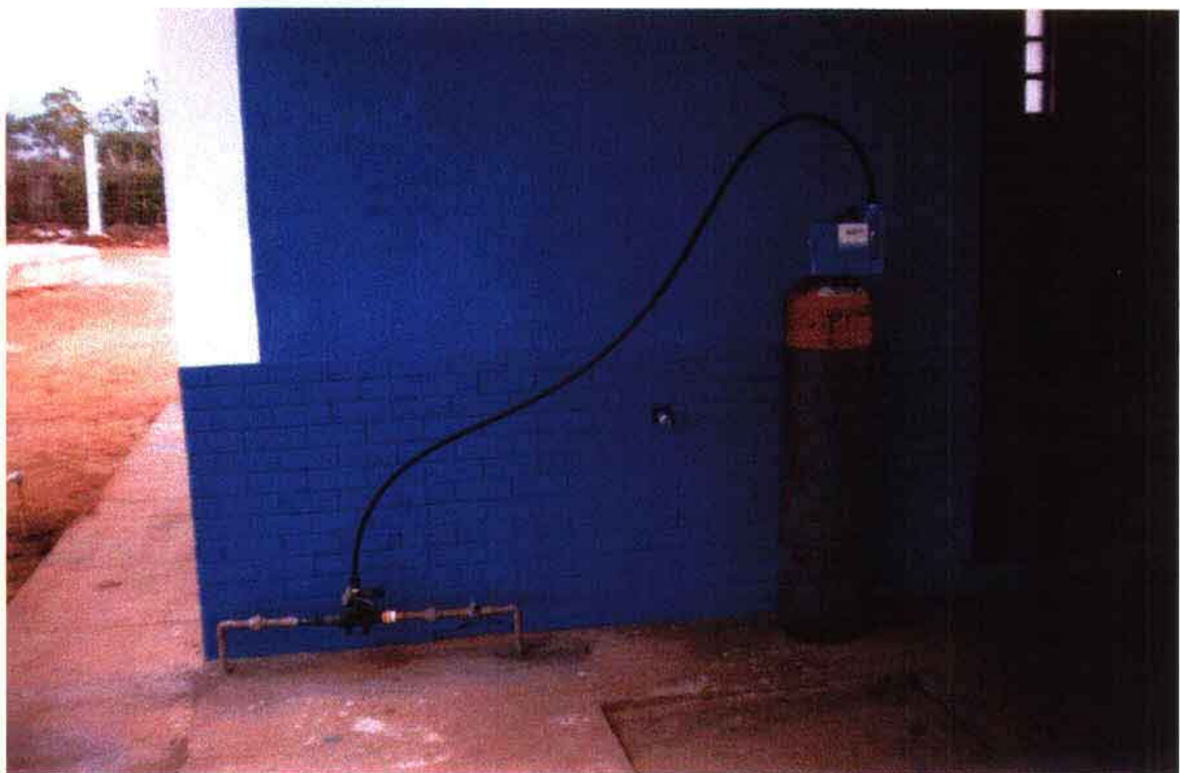
Foto 29 – Cloro gasoso injetado após a filtração.
