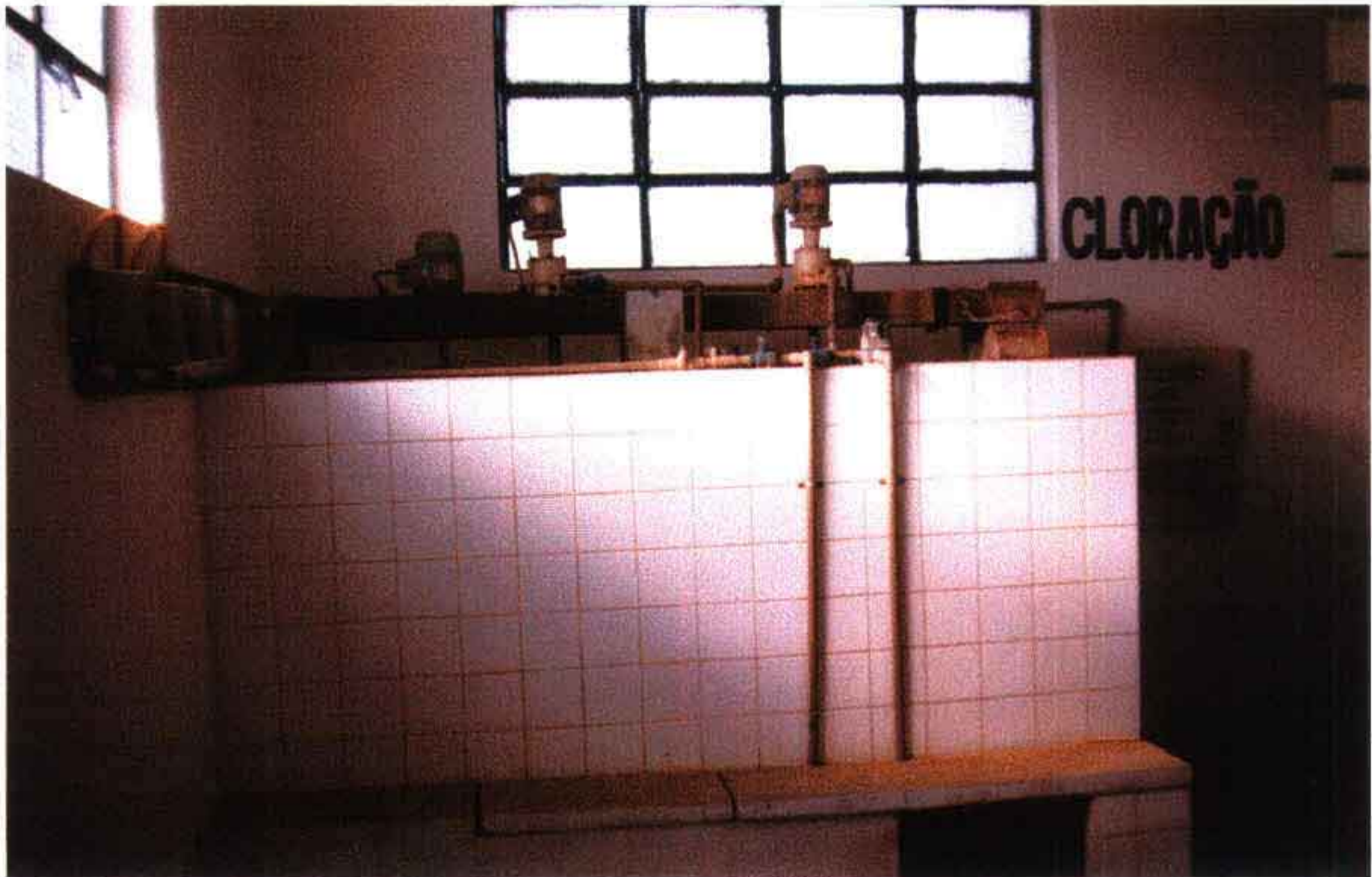
Foto 28 – Tanques para preparação e dosagem de sulfato de alumínio.
